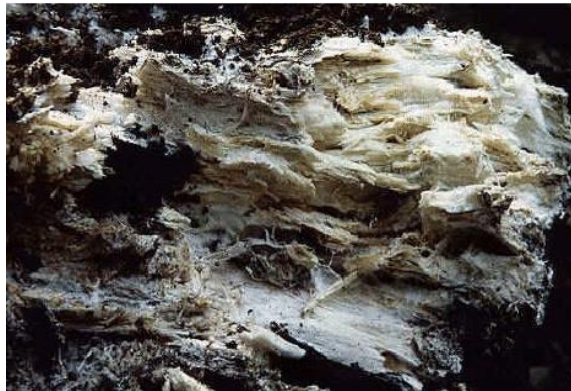
Figura 3. Madera afectada por hongos de pudrición blanca
