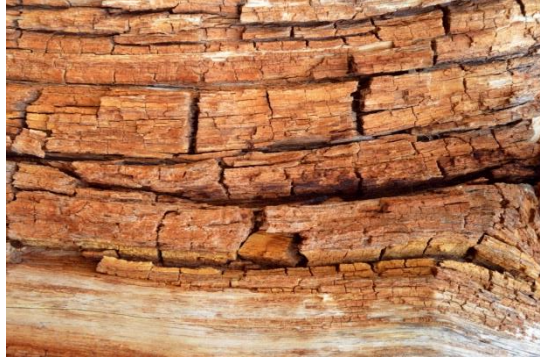
Figura 2. Madera afectada por hongos de pudrición parda
